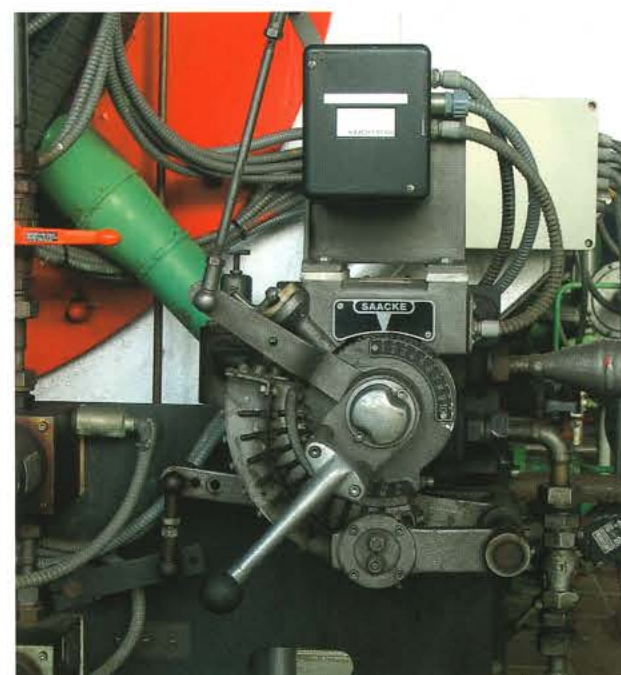
Stavnsholt kedelcentral har tre kedler med en samlet ydelse på 21,9 MW. Siden 1984 har kedel 1 og 3 været udstyret med kombibrændere til olie og naturgas. Kedel 2 bliver her i 2004 ombygget til kombibrændere, ikke mindst fordi der forventes øgede krav til fremtidens forsyningsikkerhed og brændselsvalg. (De grønne rør på billedet er forsyningsledninger med naturgas til kedelens kombibrændere).
