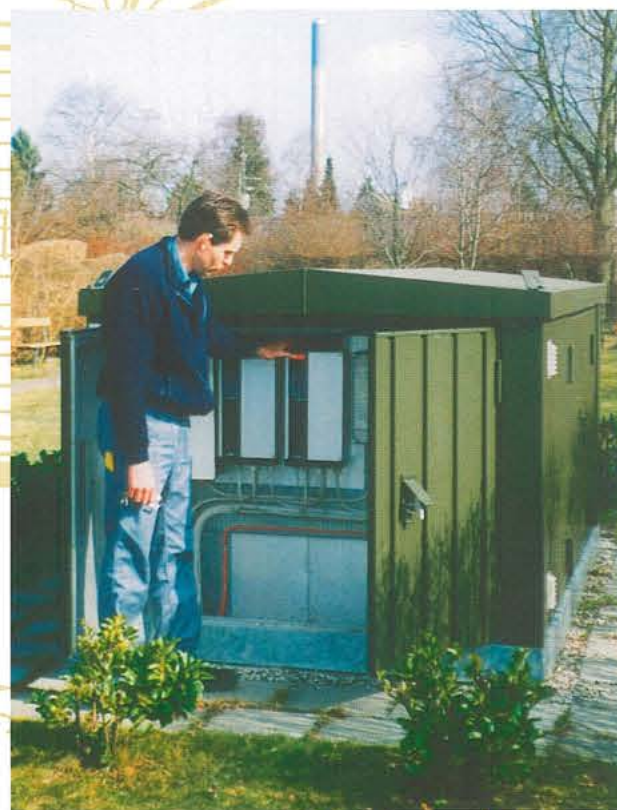
Boosterstationen, der sikrer, at trykket er tilstrækkelig højt på det varme vand, der sendes ud til de fjernest liggende områder, bl.a. udbygningen af vestbyen.
