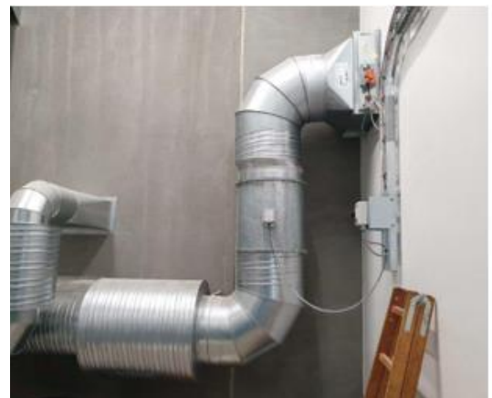
Ventilation automatisk styret spjæld (sikkerhed) luftskifte i bygningen reguleres automatisk som sikring mod kølemiddeludslip
